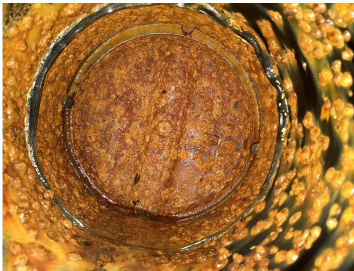
Figura 7 – Interior de adutora do sistema de distribuição com formação de tubérculos e incrustações.
