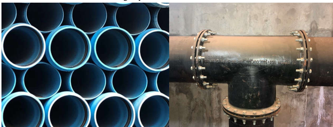
Figura 6 – Adutoras de polímeros de alta densidade utilizadas em sistemas de distribuição de água para consumo humano.
