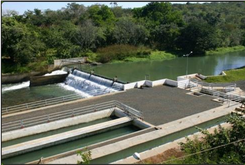
Figura 3 Sistema de captação de água no rio Uberaba em Minas Gerais
