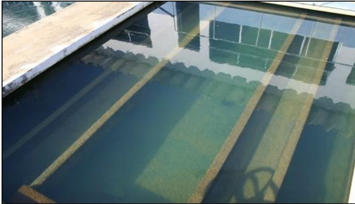
Figura 7 Tanque de filtração rápido utilizado na ETA da Codau
