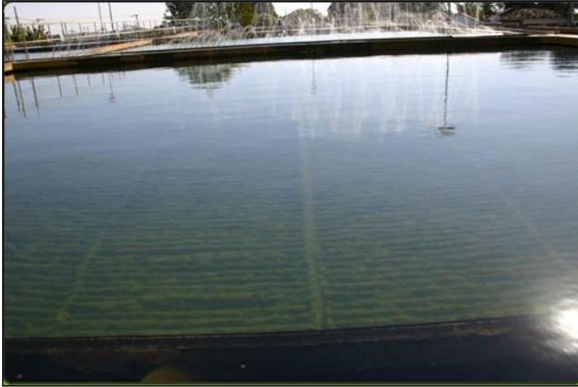
Figura 6 Tanque de decantação de fluxo laminar ascendente da ETA da Codau
