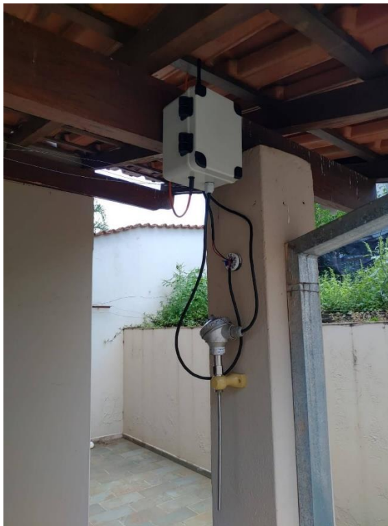
Figura 68: Protótipo e Instrumento Instalados
