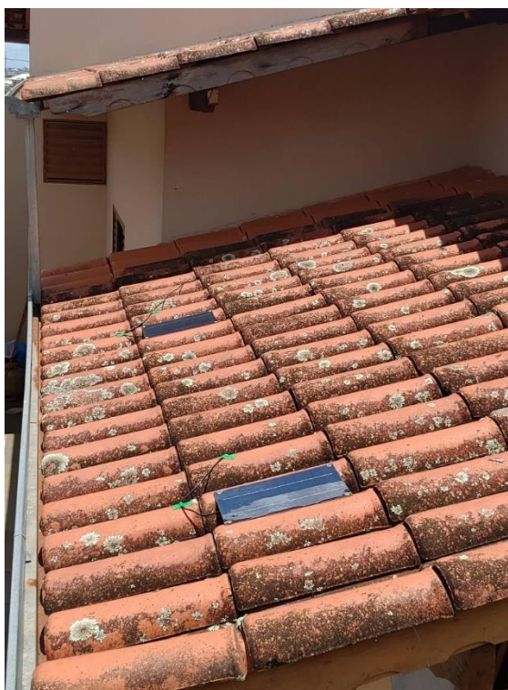
Figura 67: Placas Solares Fixadas
