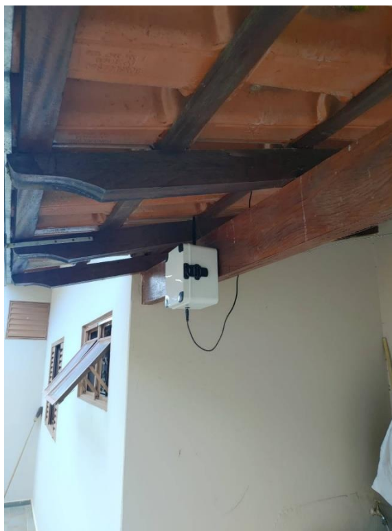
Figura 69: Protótipo Coordenador Instalado
