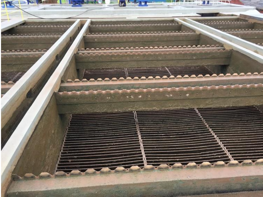
Figura 5 – Decantador Vertical da ETA 1 em Uberaba-MG.
