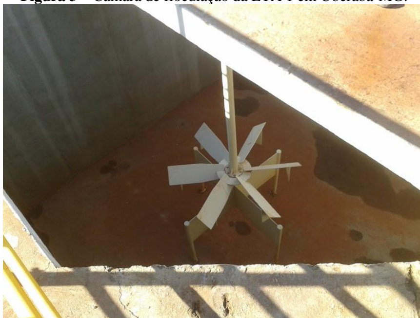
Figura 3 – Câmara de floculação da ETA 1 em Uberaba-MG.
