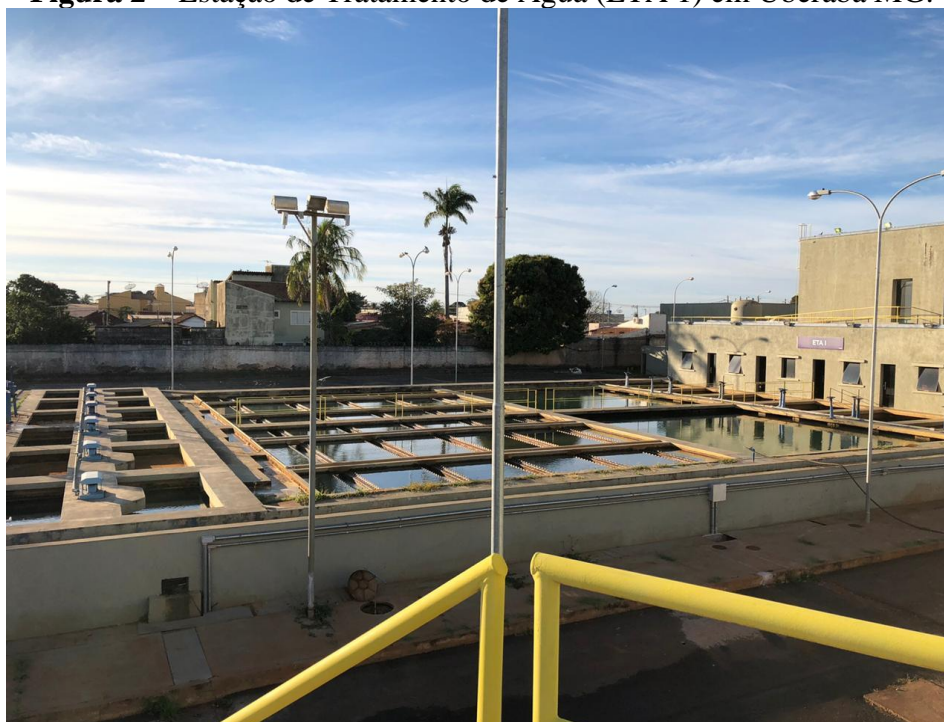
Figura 2 – Estação de Tratamento de Água (ETA 1) em Uberaba MG.
