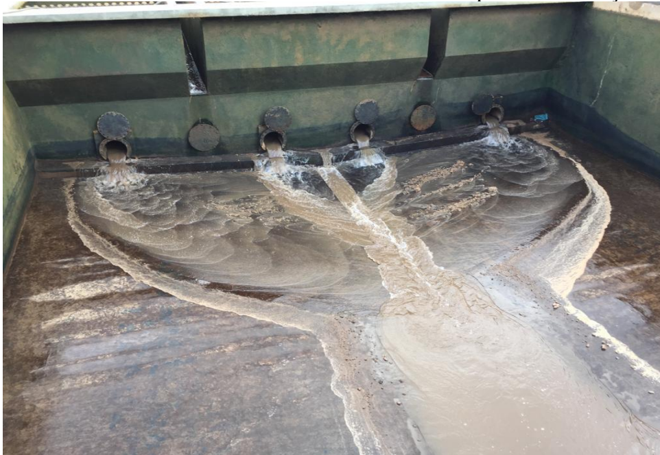
Figura 7 – Fundo abaulado com canaletas centrais de tanques de decantação - ETA
