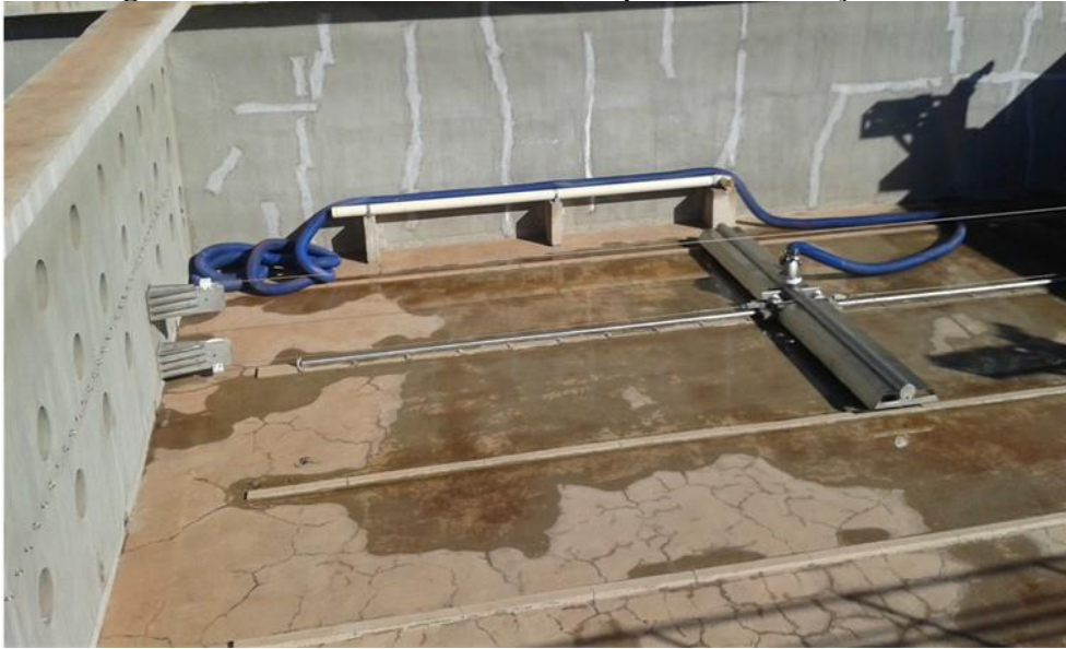
Figura 6 – Removedor de lodo de tanques de decantação - ETA
