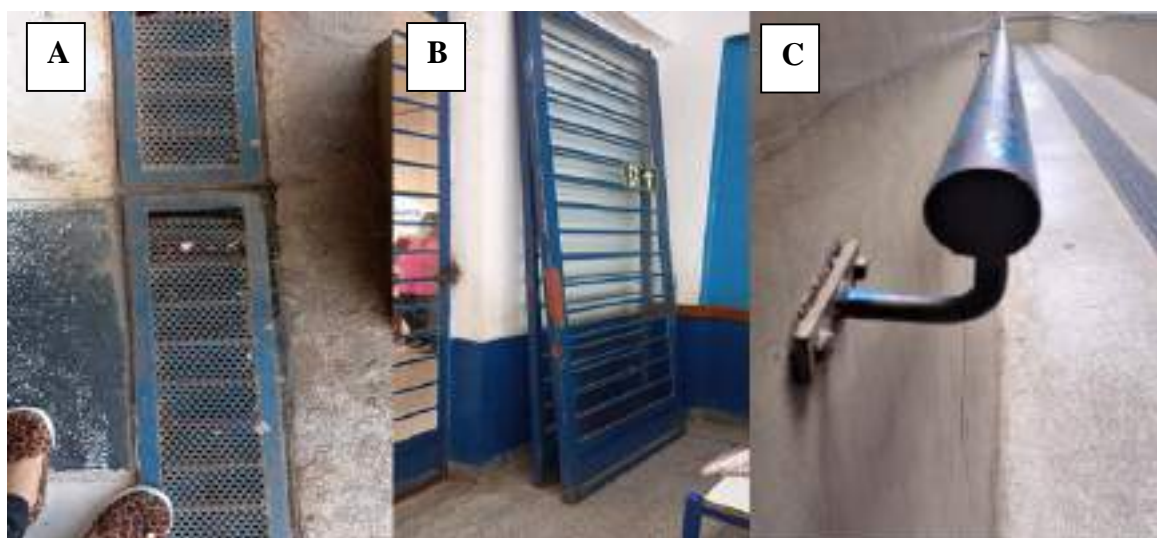
Figura 10 - Aspectos identificados sobre o tema Espaços Exteriores: A) Grelha danificada ao lado do pátio de recreação; B) Portas alocadas no refeitório da escola; C) Corrimão danificado em suas emendas.
