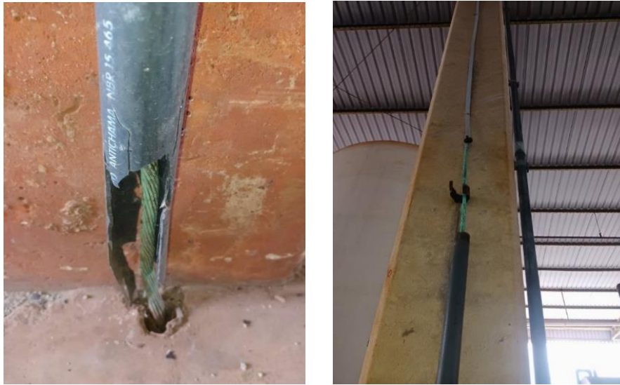
Figuras 4 e 5 – Descida oxidada do para-raios
